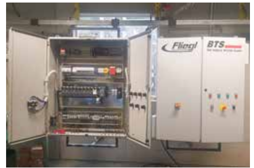
Montering af elskabe og programmering af den elektroniske styring på vores egen fabrik
